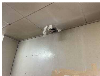
老朽化により天井に穴が開いている状況 (中部環境事業所)
