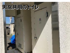
衛生設備の老朽化
